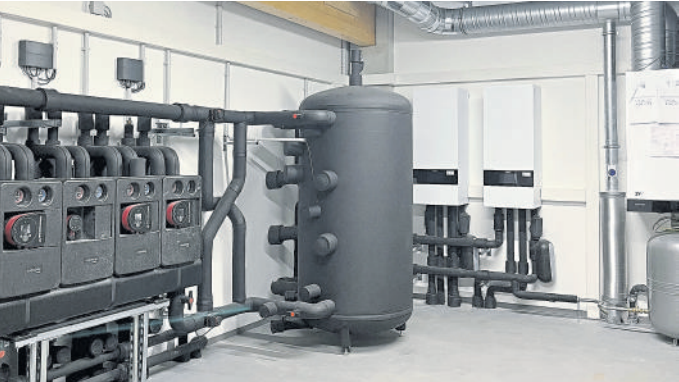
Der Technikraum im neuen Firmengebäude.
